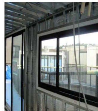
コンテナハウス (壁、床、天井)
